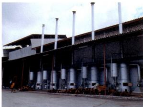
テグシガルバ付近の加工工場のボイラーによる乾燥施設。
